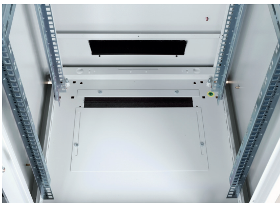
Grondplaat met kabeldoorvoer
